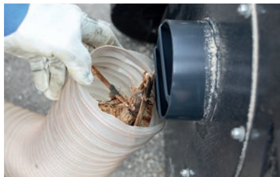
Rinden- und Holzteile verstopfen bei überlagertem Holz vermehrt die Gitterstäbe der Absauganlage.
